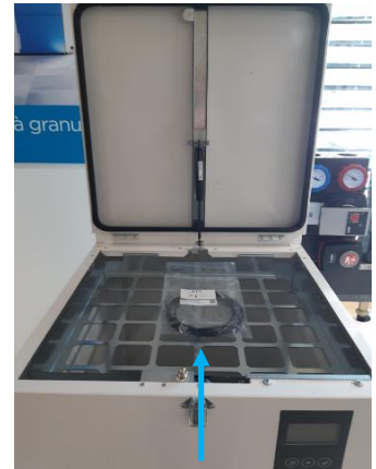
Sonde ECS à l'intérieur de la trémie de granulés
